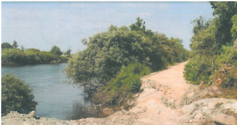
Figura 5 - aspeto do rombo na margem direita do rio Vouga em Cacia, na cheia de 2014, após trabalhos preliminares de reparação (Recursos Hídricos, vol. 37, n.º 2, Out. 2016, APRH)
